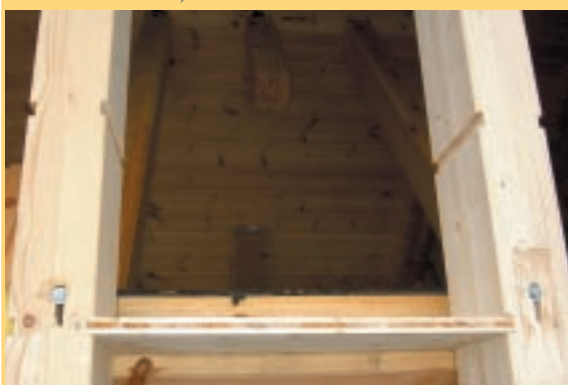
Nach der Montage bzw. vor der Setzung stehen die Stellbretter noch weit vor der Fußfette.
