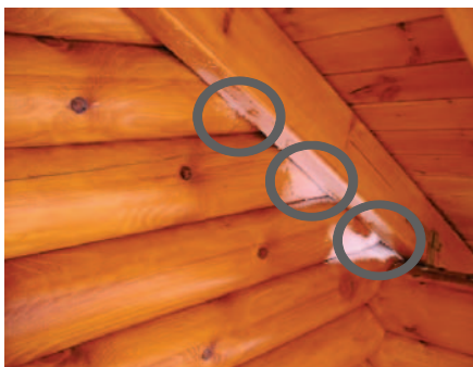
Bild 5: Raureif aus der austretenden feuchten Luft
