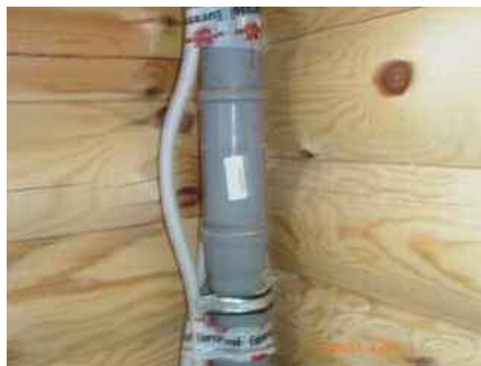
Bild 12: Langmuffe beim Abwasserrohr
